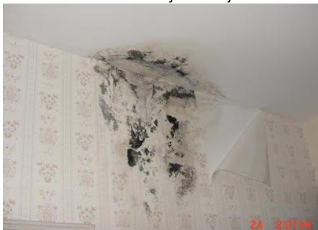
Alternaria seinä- ja laekahjustus
